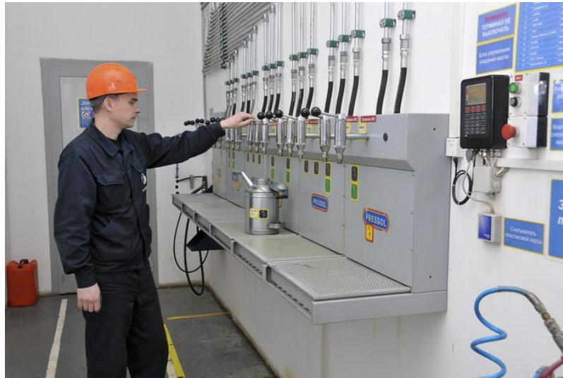
Рис. 5.7. Автоматизований пост роздавання змащення в умовах ВРП
