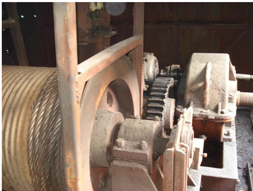
Рис. 2.2. Загальний вигляд тягової станції
