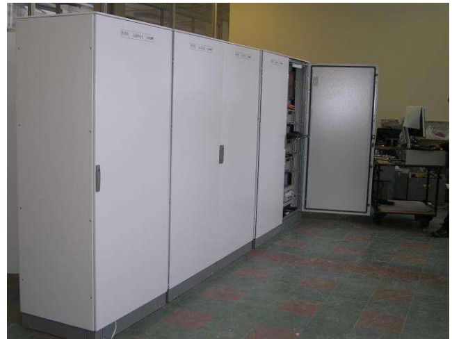
Рис.1. Общий вид всех шкафов управления МПЦ станции Угольная (19 централизуемых стрелок)
