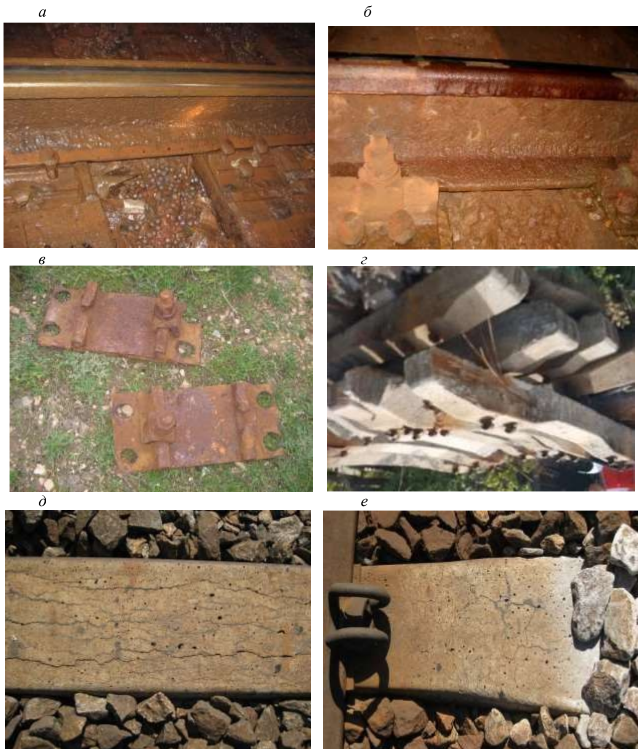
Рис. 4. Електрокорозійні пошкодження елементів верхньої будови колії в тунелях без зворотного склепіння (з природною основною площадкою): Бескидському (старому) Львівській залізниці (а), Сухарному Придніпровської залізниці (б, в) і на ділянці Основа – Букине Південної залізниці (г-е): а – шийки та підшви рейки, костильного скріплення Д0; б – шийки та підшви рейки, клемно-шурупного скріплення Д2; в – підкладок скріплення Д2; г – арматури залізобетонних шпал типу СБ3; г-е – бетону шпал типу СБ3
