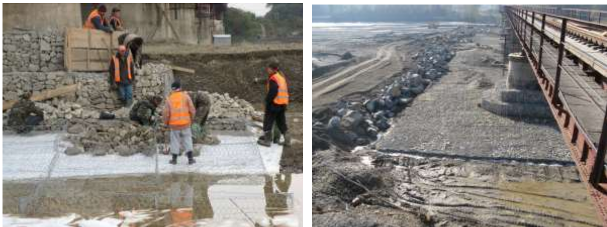
Рис. 5.6. Укріплення габіонами: а – укосів насипу або берми; б – берега водоймища або водотоку; в – улаштування і вигляд укріплення поверхонь габіонами (Львівська залізниця)
