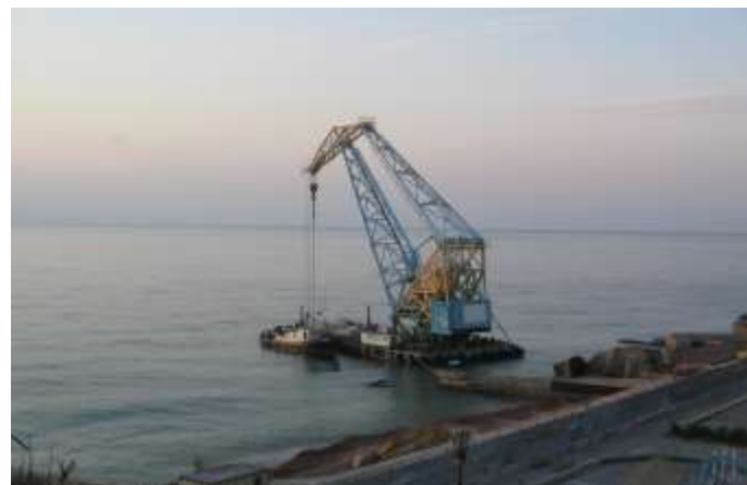
Рис. 5.12. Гравітаційні поперечні буни: а – схема конструкції; б – пошкоджена бун; в – ремонт бун за допомогою плавучого крана; 1 – укiсна стiна; 2 – коренева частина; 3 – блоки; 4 – шпонки; 5 – кам'яна постiль; 6 – монолiтна плита; 7 – проєктна поверхня пляжу; а – глибина можливого розмиву
