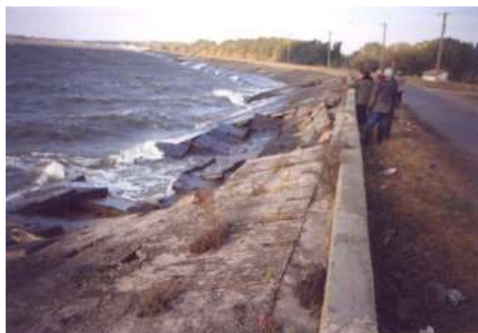
Рис. 5.9. Укріплення укосів залізобетонними плитами: а – схема укріплення укосу; б – вигляд укріплення укосу з пошкодженнями
