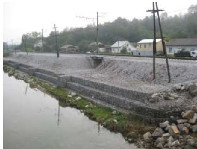
Рис. 5.10. Габіонні стіни: a – гравітаційна ( H/b_\phi < 1,5 ); б – півгравітаційна ( H/b_\phi > 1,5 ); в – східчаста; г – тонка стінка з анкеруванням; д, е, ж – улаштування і вигляд габіонних стін (Львівська залізниця)
