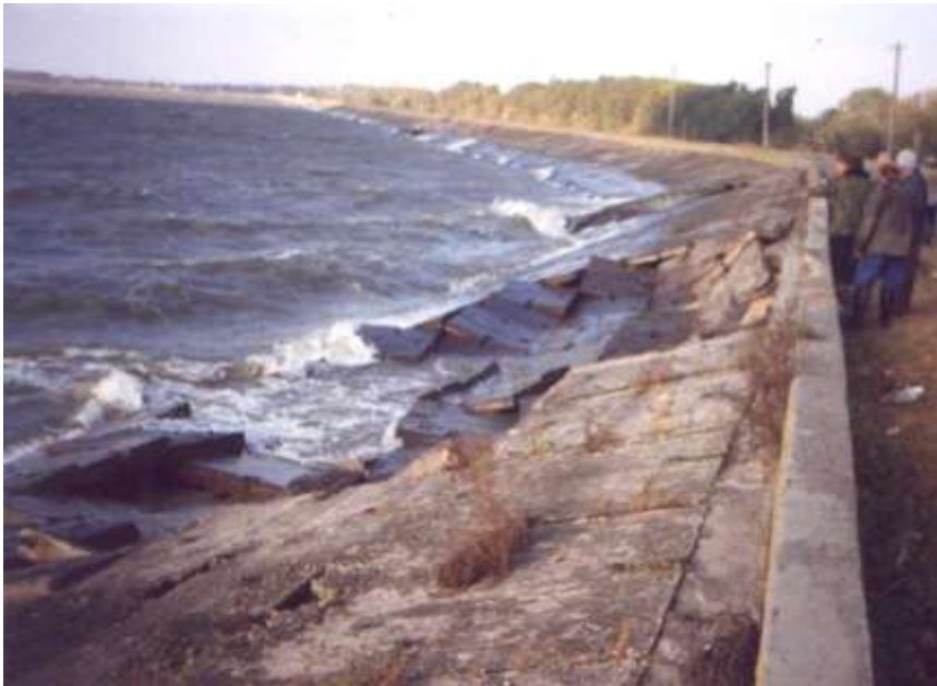
Рис. 3.37. Підмив берега моря (озера, водосховища) поблизу земляного полотна, захисних і укріплювальних споруд: a – схема підмиву; б – руйнування конструкцій закріплення берегів внаслідок підмиву; 1 – рівень води у водоймищі; 2 – пляжні відкладення; 3 – ніша підмиву берегового схилу; 4 – поздовжня тріщина
