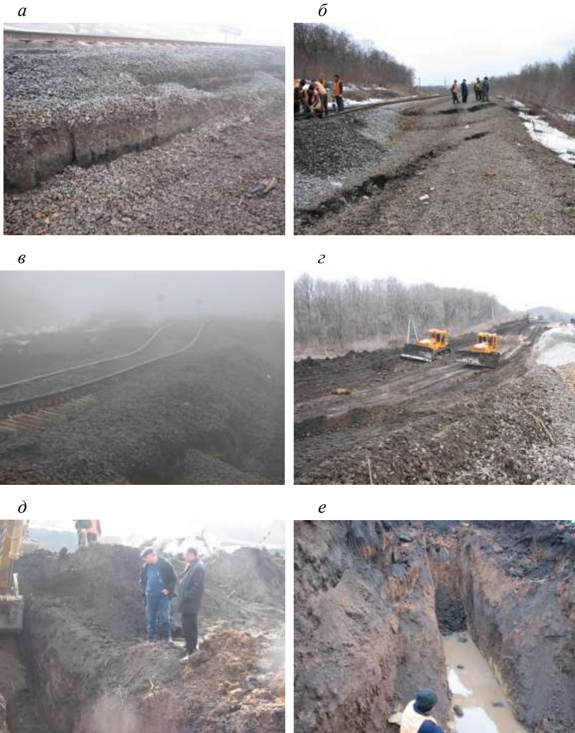
Рис. 5.27. Улаштування дренажних пристроїв під час ліквідації наслідків зсуву біля з. п. Кривошиївка ділянки Куп'янськ – Сватове Південної залізниці, березень 2006 р.: а – брівка зриву зсуву біля колій; б – виправлення колії; в – накопичення розладів колії, що не піддаються виправленню; г – демонтаж колії та вирівнювання земляного полотна після стабілізації зсуву; д, е – улаштування поперечного прорізу
