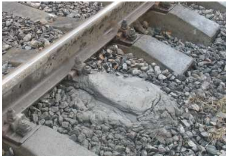
Рис. 3.1. Баластові корита: а – схема дефекту; б – виплеск як ознака наявності баластових корита, ложа, мішку, гнізд: 1 – баластове корито; 2 – баластовий шар; 3 – глинисті ґрунти; 4 – контакт баластових матеріалів і глинистих ґрунтів
