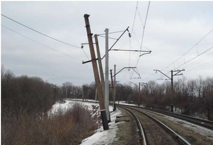
Рис. 3.3. Баластовий мішок: а – схема дефекту; б – нахил опор контактної мережі як ознака наявності баластових мішку та гнізд: 1 – баластове корито; 2 – будівельний поперечний профіль; 3 – випирання ґрунту внаслідок утворення баластового мішка; 4 – глинисті ґрунти; 5 – контакт баластових матеріалів і глинистих ґрунтів
