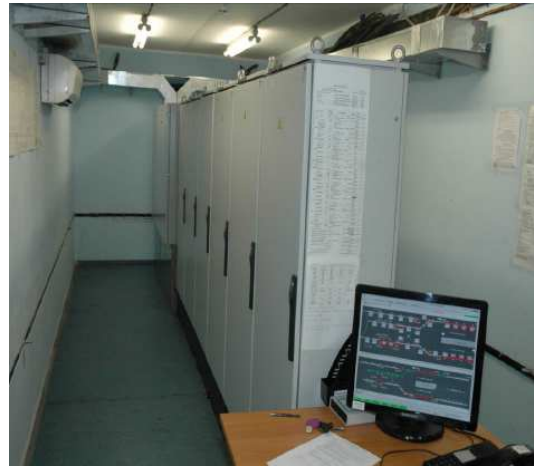
Рис. 3. Блокове приміщення МПЦ
