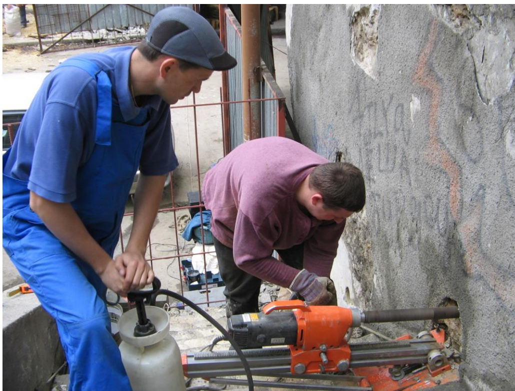
Рис.3.8. Обстеження залізничного мосту в Одесі. Травень 2006 р.
