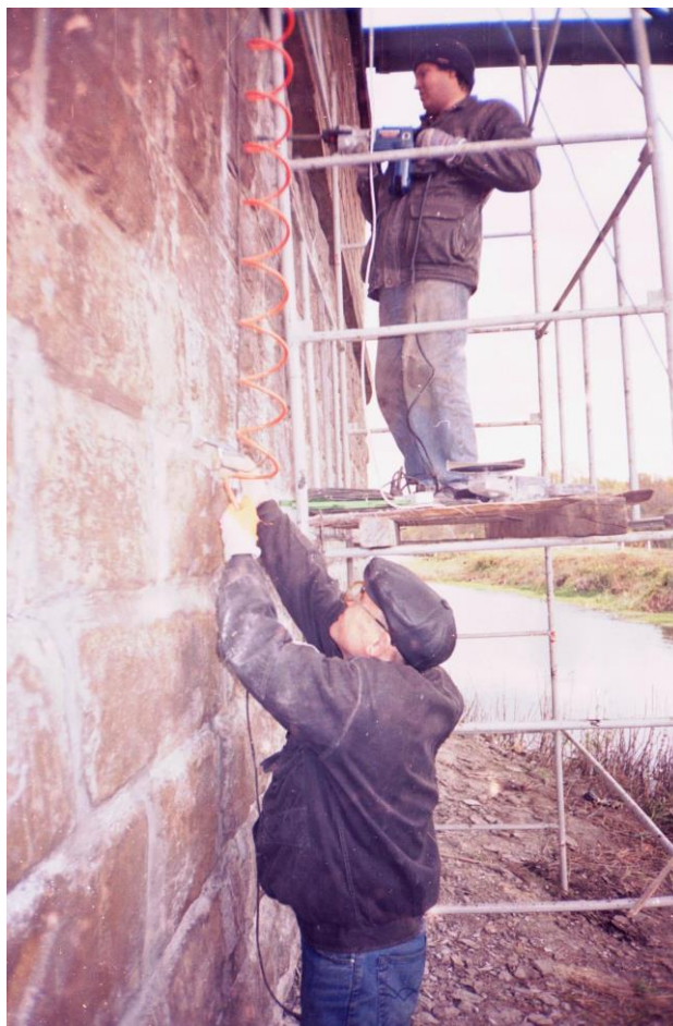
Рис. 4.7. Ремонт опори мосту через р. Сіверський Донець біля ст. Будинок відпочинку Південної залізниці. 2003 - 2006 рр.
