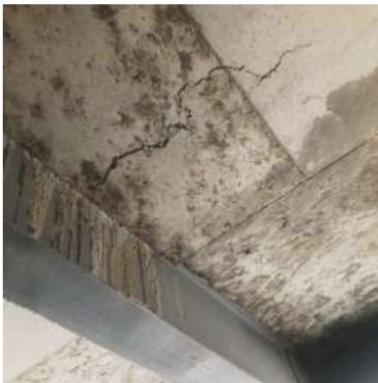
Рис. 1 – Пошкодження бетонної полочки сталезалізобетонного перекриття
