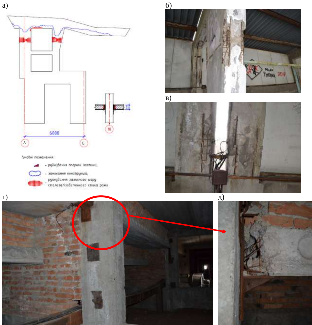
Рис. 1 – Пошкодження несучих конструкцій спортивної споруди
