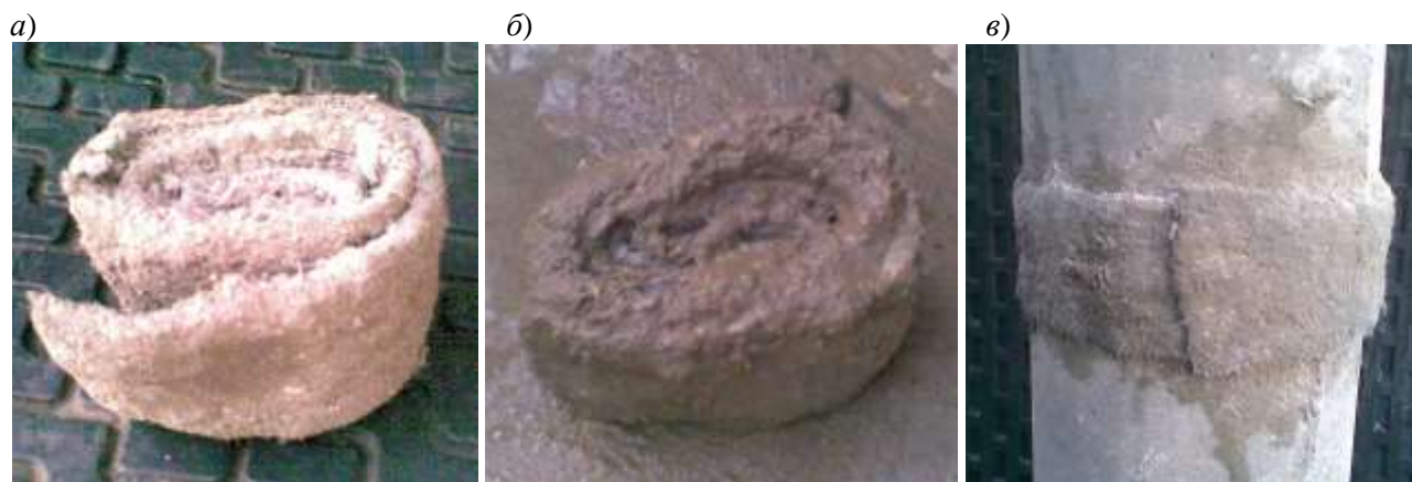
Рис. 1. Рулонный композиционный материал РКМ и его применение: а – рулон; б – водонасыщенный РКМ; в – наклеивание РКМ на поверхность – склейка двух бетонных труб
