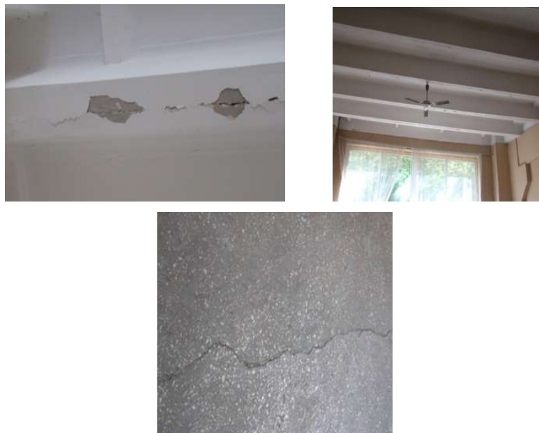
Рис. 2. Пошкодження несучих конструкцій каркасу будівлі
