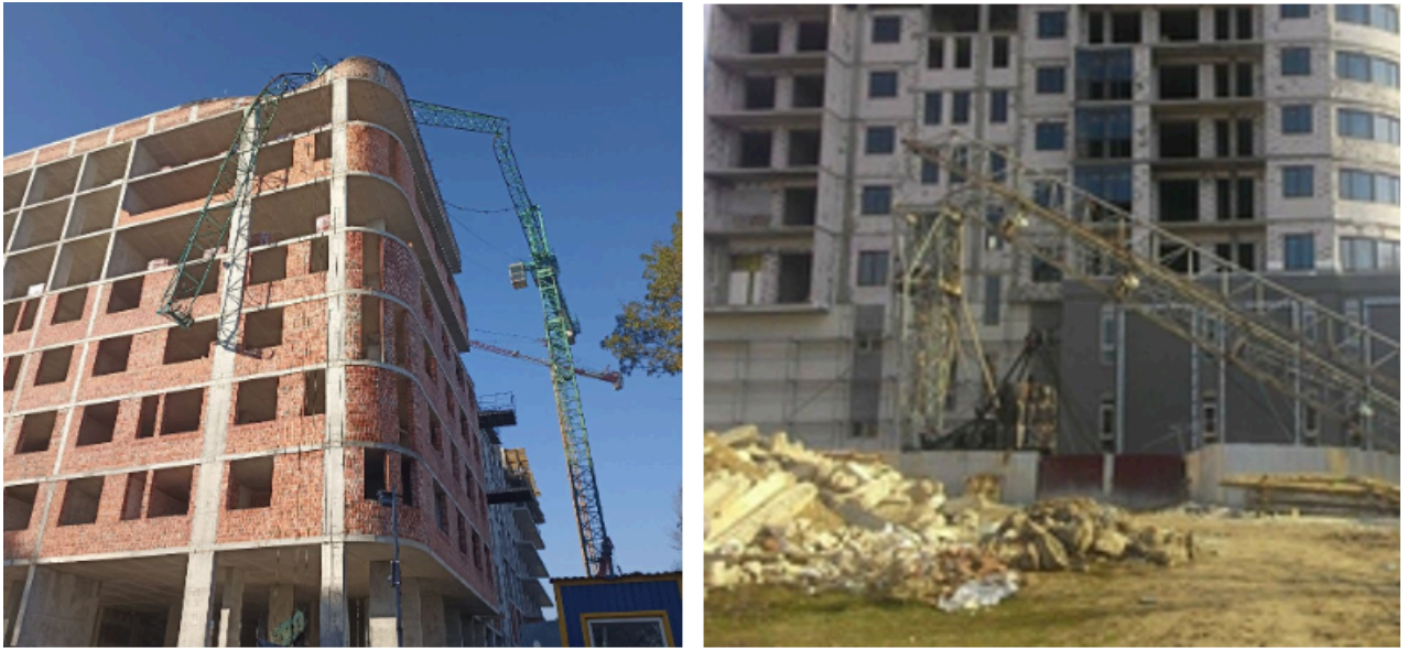
Рис. 1.1. Аварії баштових кранів, з руйнуванням: стріли (м. Львів 24.10.24) та башти (м. Рівне 16.03.16)
