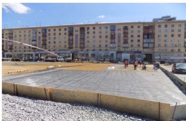
Рис. 1. Загальний вид плити дорожнього покриття пл. Павлівська у м. Харкові
