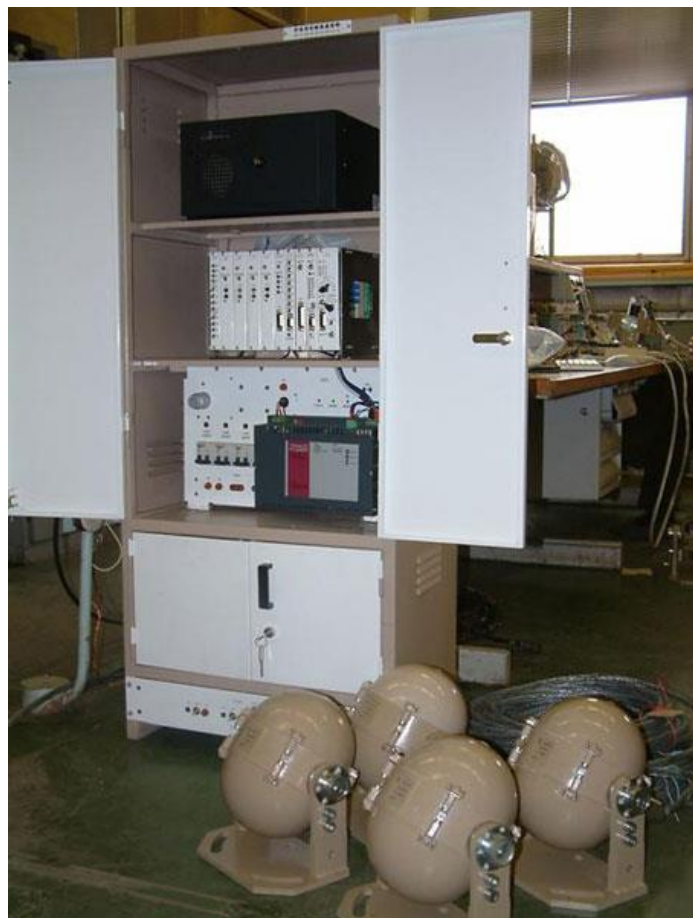
Рисунок 10.9 — Загальний вигляд стійки управління перегінним обладнанням системи АСДК-Б
