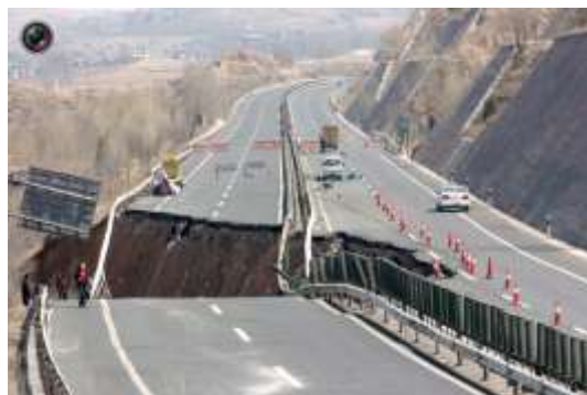
Рис. 2. Провал на мосту в Чебоксарах [5]
